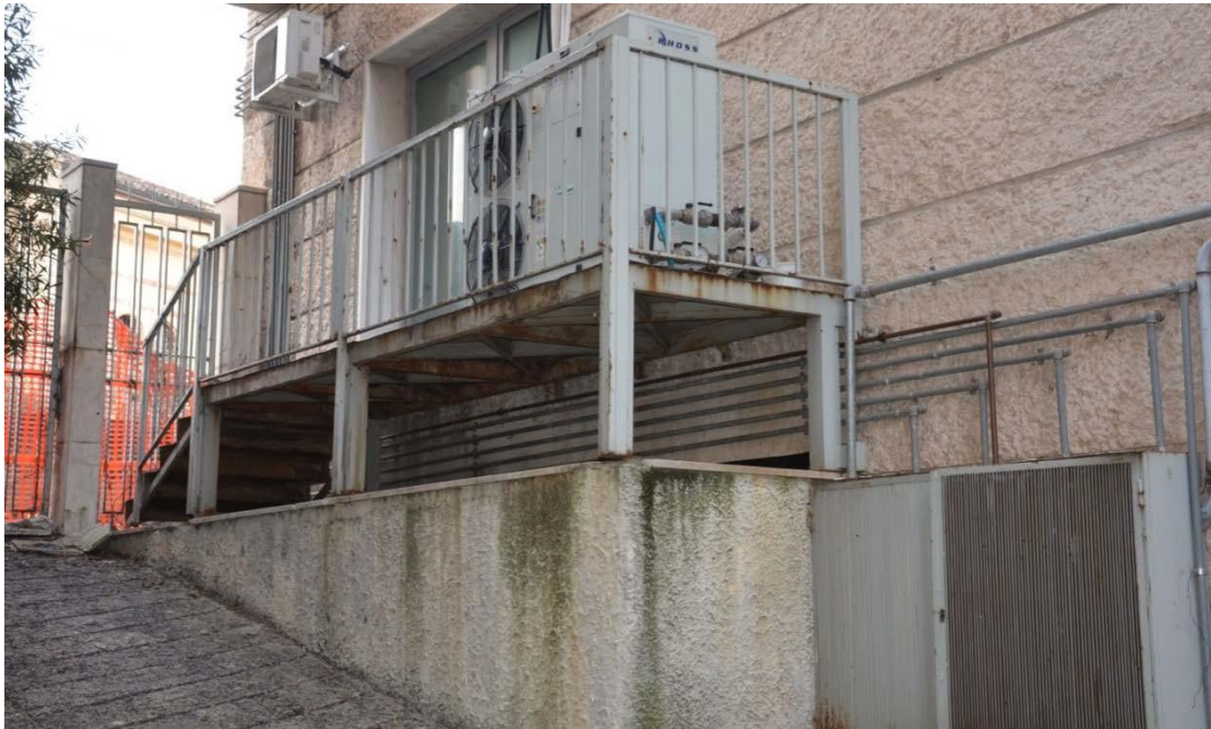
FOTO 12: particolare della terrazza metallica posizionata nell'area urbana sub 111
