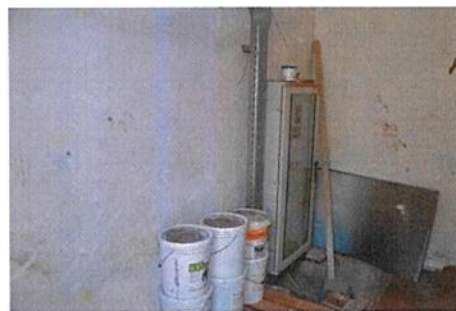
Il locale ENEL dall'interno
