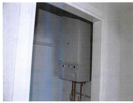
Ripostiglio e caldaia al primo piano
