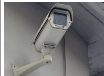
#6: Impianto Antifurto e Videosorveglianza
