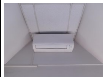
#9: N. 4 Condizionatori Daikin
