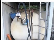
#28: Serbatoio per Gasolio
