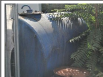
#43: Cisterna per Gasolio
