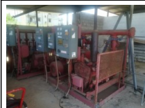
#8: Gruppo di Pompaggio
