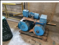
#12: N. 3 Motori Elettrici
