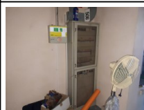
#32: Impianto di Allarme
