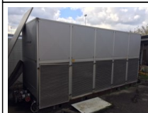
#7: Pompa Esterna Euro-Chiller
