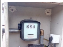
#115: Deposito Gas-Oil 2.000 Litros Y Surtidor
