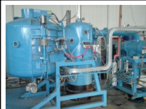
#6: Impianti Metallizzazione CO-BI
