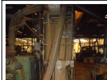
#34: Sottostazione di Aspirazione
