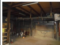
#74: Cabina di Verniciatura a Secco
