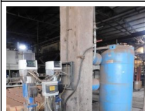
#77: N. 2 Bombas Lowara Hydrovar
