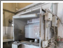
#104: Cabina de Pintura a Água
