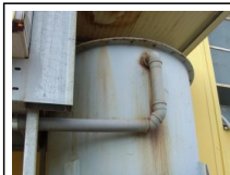
#13: Serbatoio con Vasca di Raccolta
