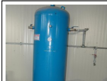
#1: Compressore, Essiccatore e Serbatoio
