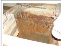
#6: Vasca di Depurazione
