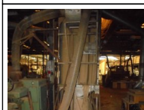
#34: Sottostazione di Aspirazione
