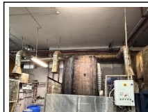
#10: Impianto aspirazione vapore
