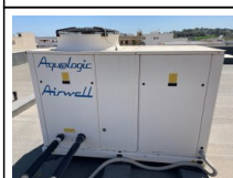
#9: Gruppo Climatizzazione, Caldaia e Miscelatore
