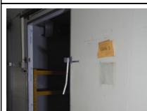
#14: N. 2 Câmaras Frigoríficas - 6,00m x 4,70m
