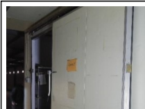
#13: Câmara Frigorífica - 4.60 m x 4.70m
