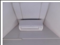
#9: N. 4 Klimatyzatory Daikin
