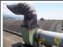
#156: Impianto di Aspirazione Saldatrici a Proiezione
