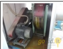
#155: Impianto di Aspirazione Trasfer/Presse Cuber/Saldatrici Ottone
