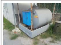
#10: Cisterna con Vasca di Contenimento
