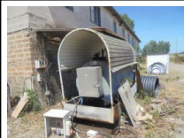
#34: Cisterna per Gasolio METALSERBATOI
