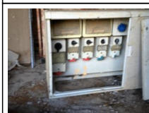
#17: Quadro Elettrico da Cantiere IMER
