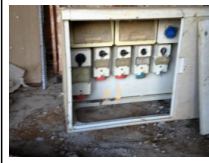
#17: Quadro Elettrico da Cantiere IMER
