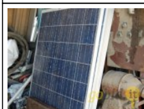
#15: N. 3 Pannelli Fotovoltaici guasti
