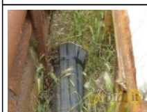
#22: Tubazione in gomma per irrigazione
